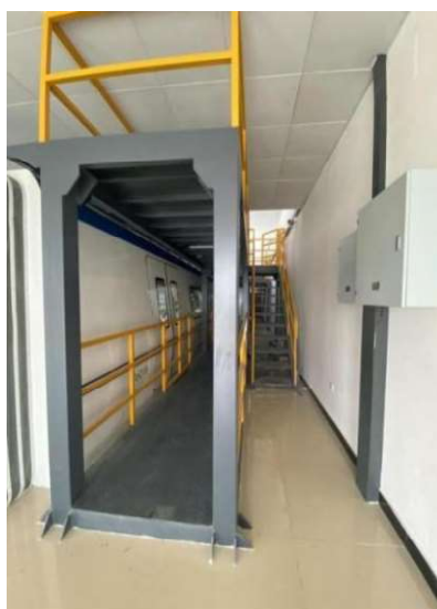
图 29 检修平台实物图
