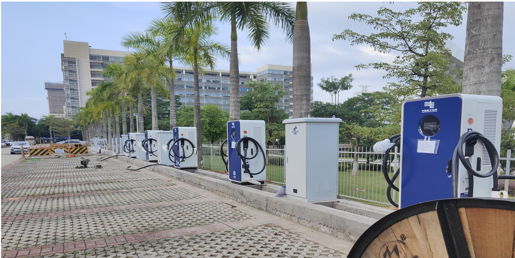
广州黄埔华南新材料园公共充电站
