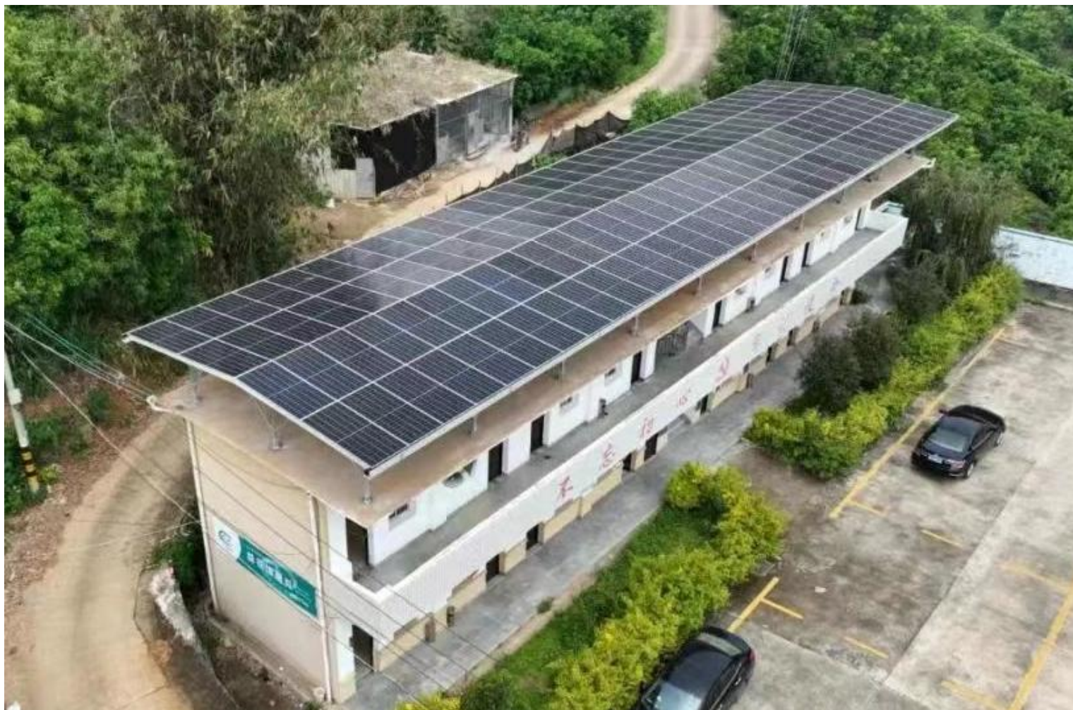
漳州平和整县开发分布式光伏项目
