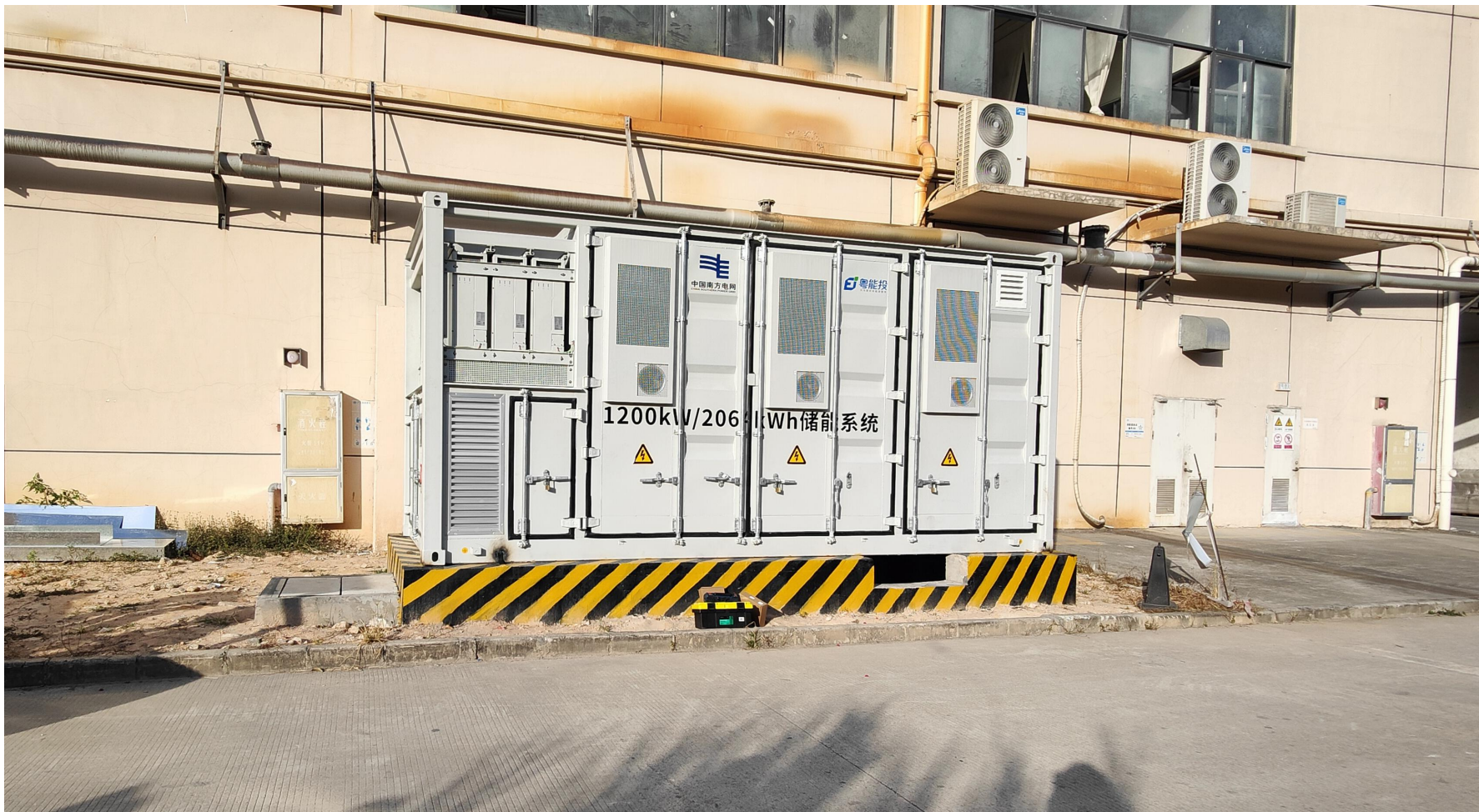
森源蒙玛用户侧储能项目
