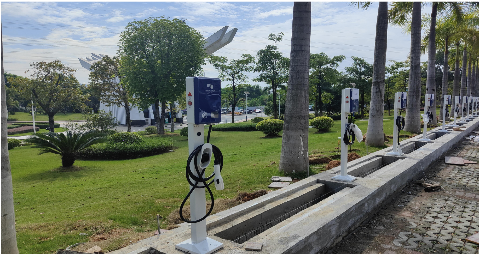
广州黄埔华南新材料园公共充电站
